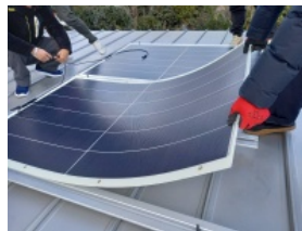
ペラペラ太陽光の施工の様子 (出所：ティーエスピー) クリックすると拡大した画像が開きます
